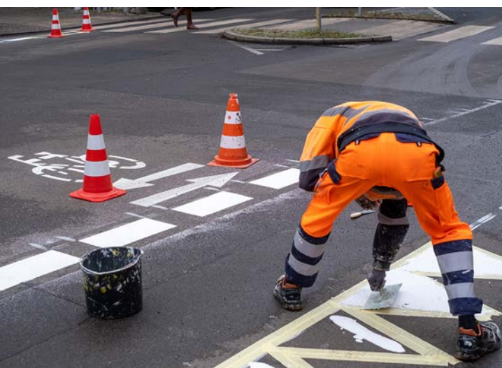
Der Arbeitsplatz Straße bringt besondere Gefahren mit sich.
