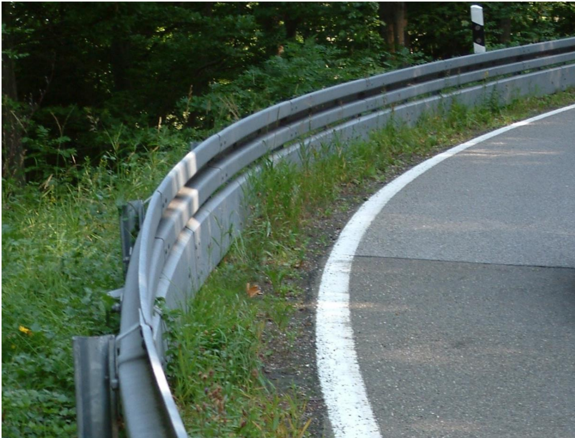
Nachgerüsteter Unterfahrschutz in Bayern (über 800 Kurven)
