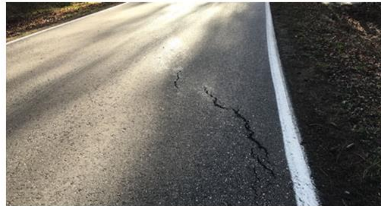
Risse in der Fahrbahn
