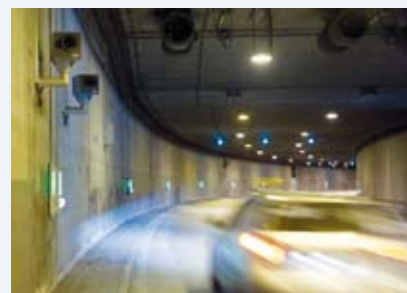
Überwachung erhöht die Sicherheit in Tunneln.
